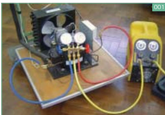
Manifold conectado às conexões de serviço do sistema de refrigeração pelos lados de alta e baixa pressão
