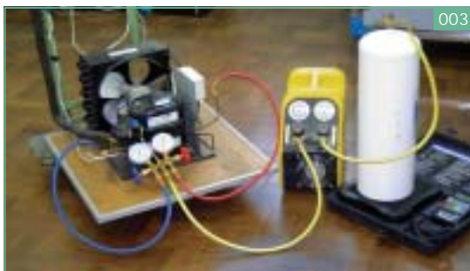
Conexão da unidade de recolhimento com cilindro de recolhimento sem dispositivo de controle de nível
