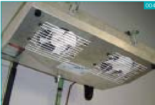
Unidade evaporadora de sistema frigorífico
