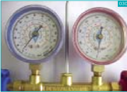
Detalhes do Manifold. Diferentes etiquetas para cada refrigerante (R134a,R404)
